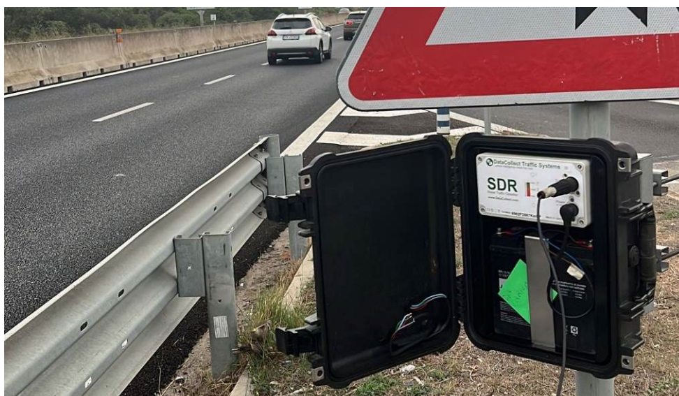
Figura 11 – Particolare dello strumento utilizzato per il conteggio del traffico veicolare della SS195
