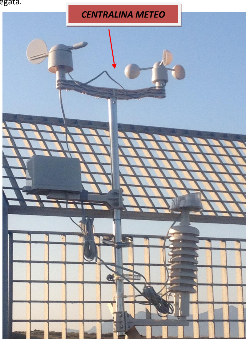
Vista della centralino meteo.
