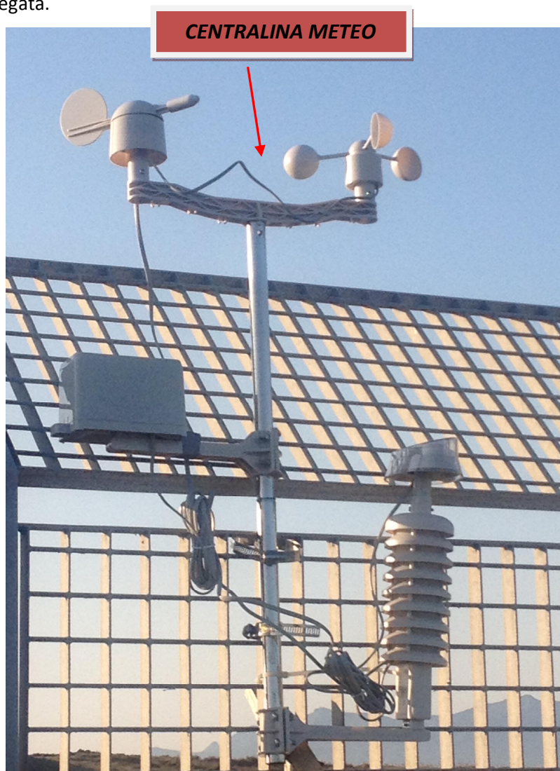
Vista della centralino meteo.
