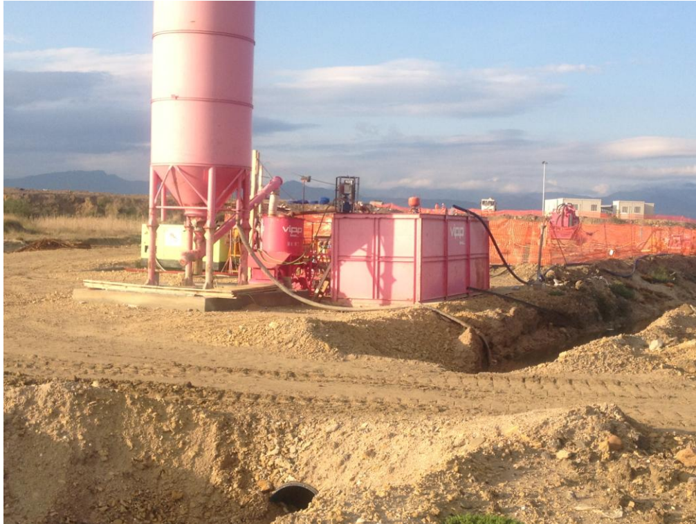
Foto 4: Vista dell'impianto di recupero della Bentonite
