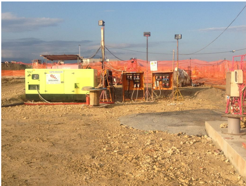
Foto 1: Vista del gruppo elettrogeno
