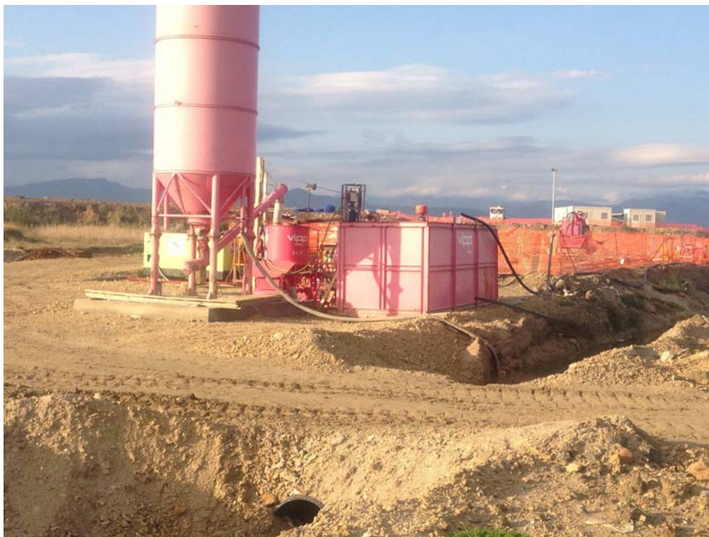
Foto 4: Vista dell'impianto di recupero della Bentonite
