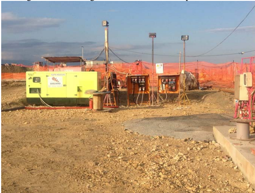
Foto 1: Vista del gruppo elettrogeno
