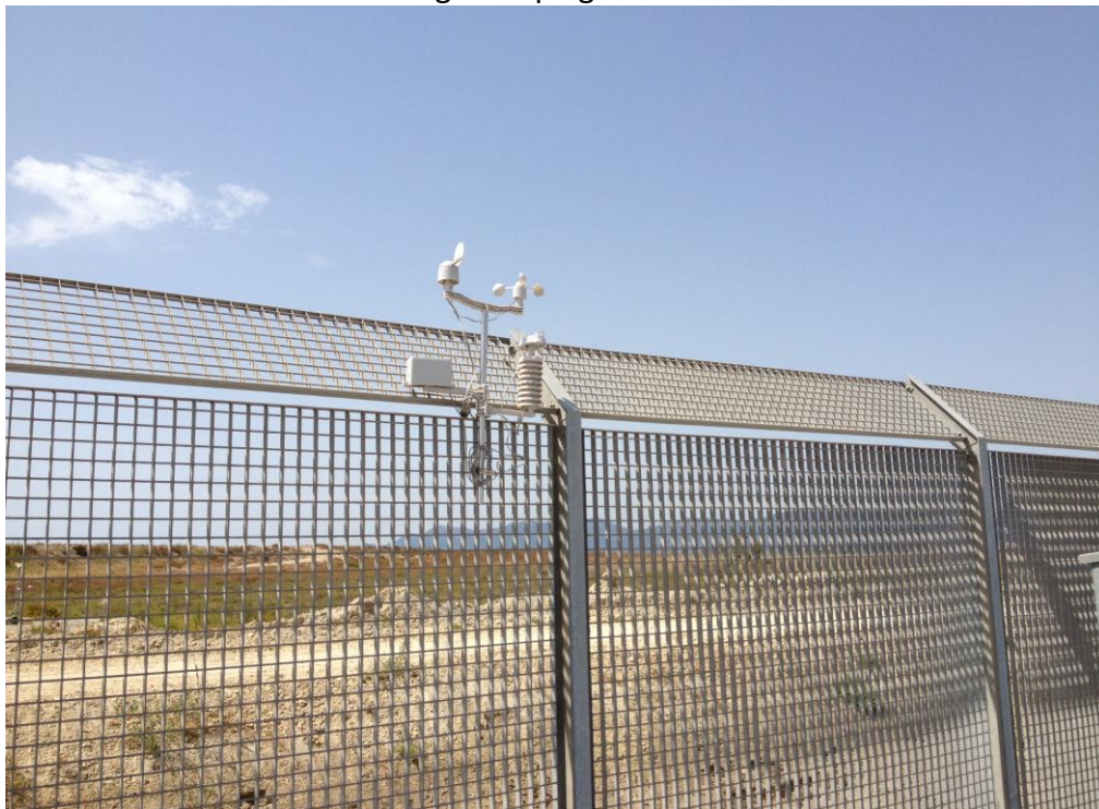
Foto 4: Centralina meteo fissa
