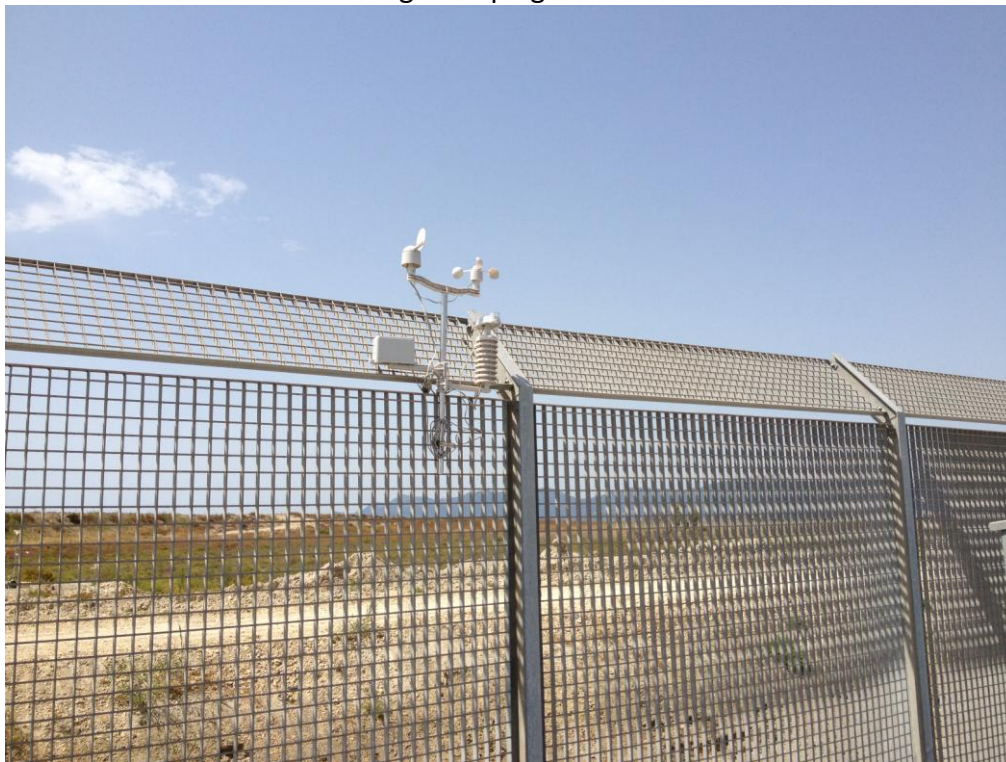
Foto 4: Centralina meteo fissa
