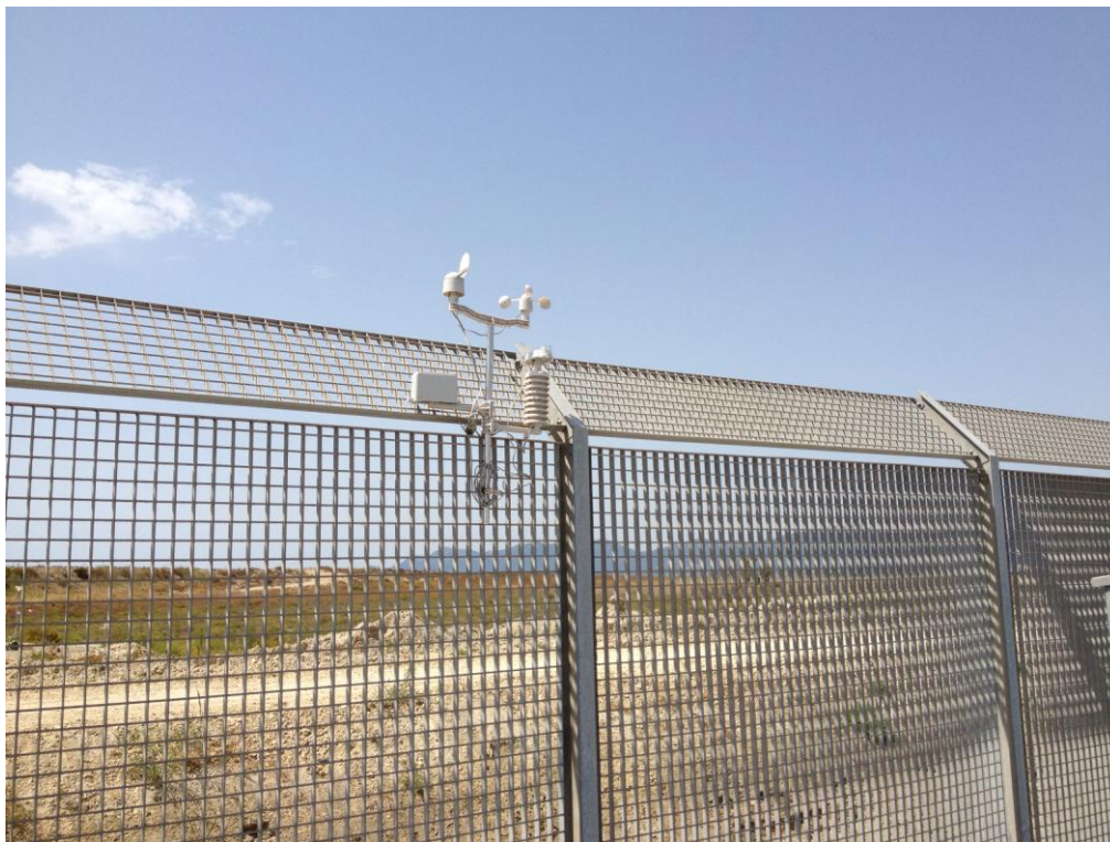
Foto 7: Centralina meteo fissa
