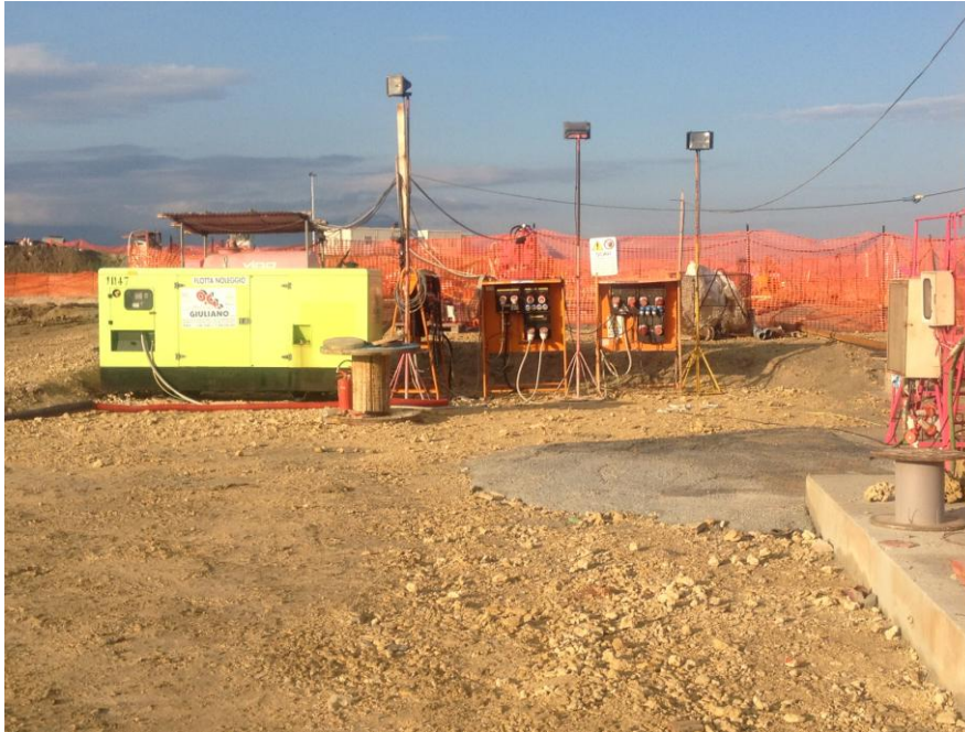
Foto 1: Vista del gruppo elettrogeno
